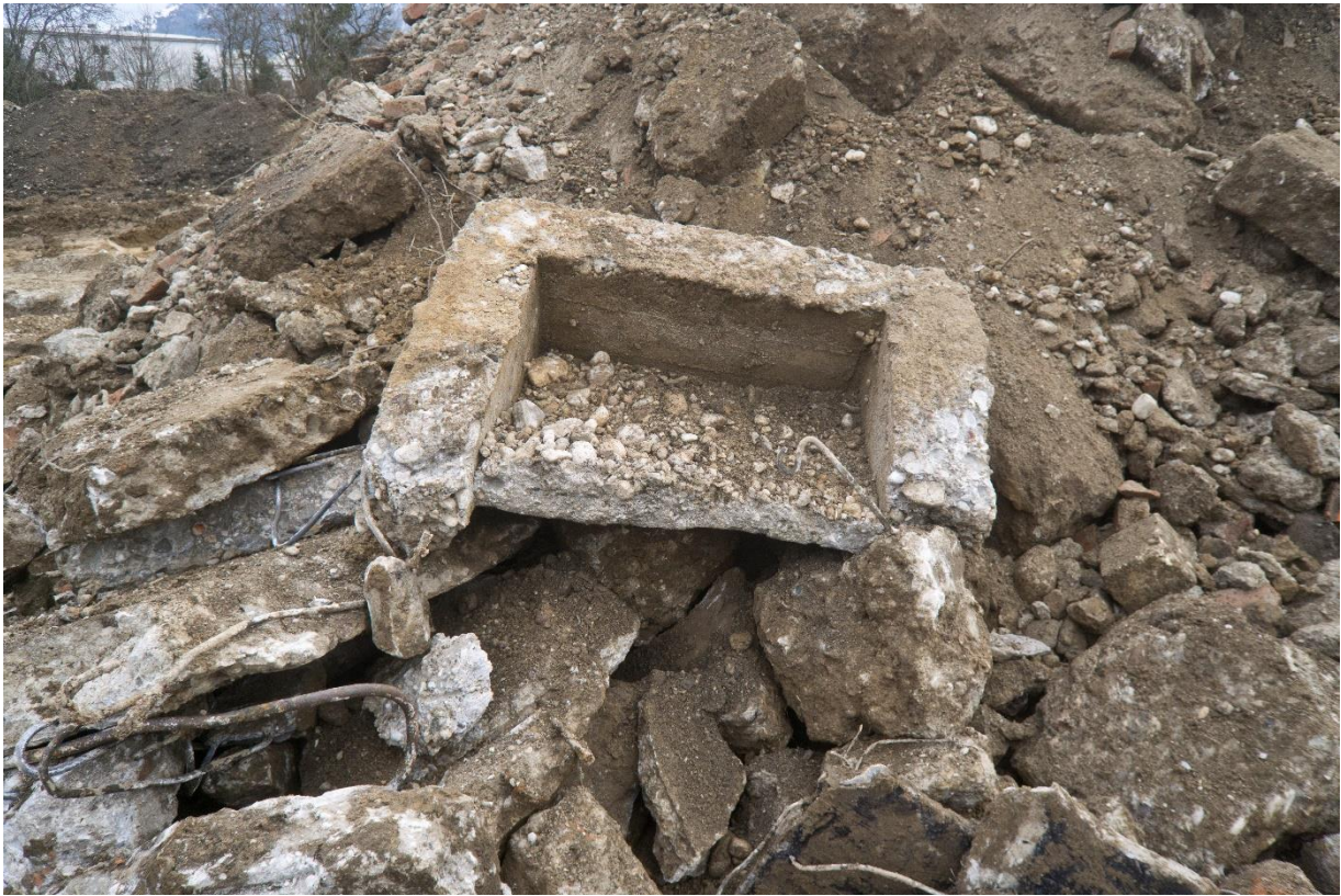
Abbildung 7: Detailaufnahme des aus dem Keller geborgenen Überrests der mutmaßlichen Kohleschütte, über die von außen das Brennmaterial in den Keller verfrachtet werden konnte. Der auf den ersten Blick eher als Treppenstufe einzuschätzende Betonbrocken, liegt hier auf dem Kopf und war mit einer deutlichen Neigung angefertigt worden, eine Treppe dürfte daher ausscheiden. ©X-Cavate Archaeology
